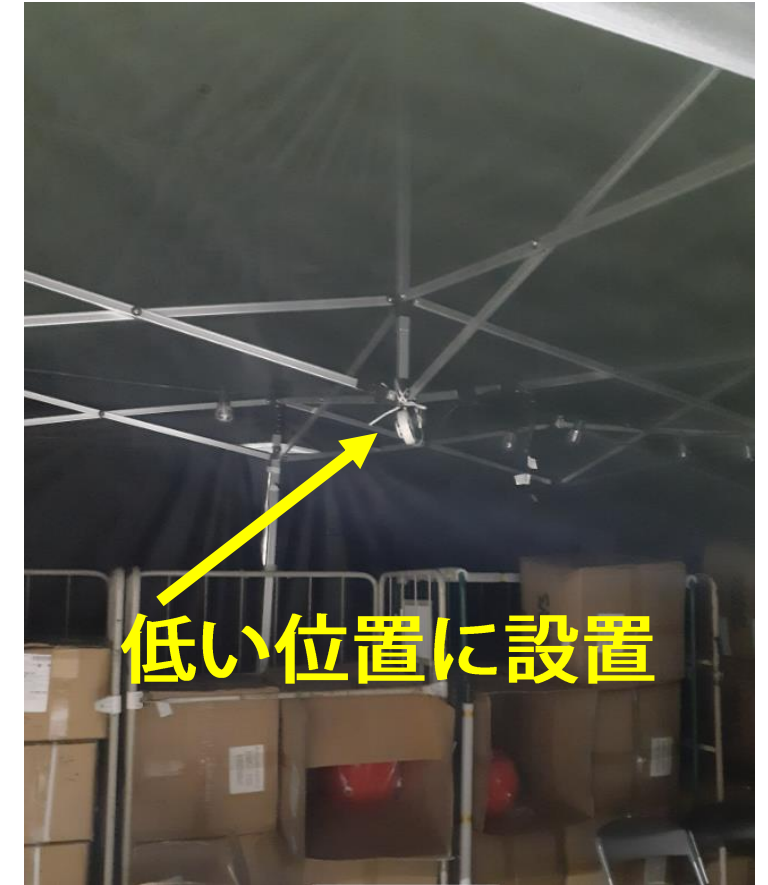
(×正しくない取付位置)
